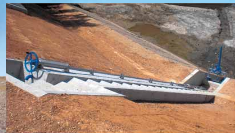
●桑名市深谷部 (桑名市農政環境事務所) 斜樋ゲート 23L 1連 φ200mm×φ300mm 底樋ゲート 1門 0.8m×0.8m
