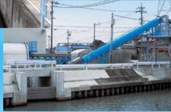
●千倉排水機場 (桑名農政環境事務所) 背面降下前面掻揚式 除塵機 3.2m×3.8m
