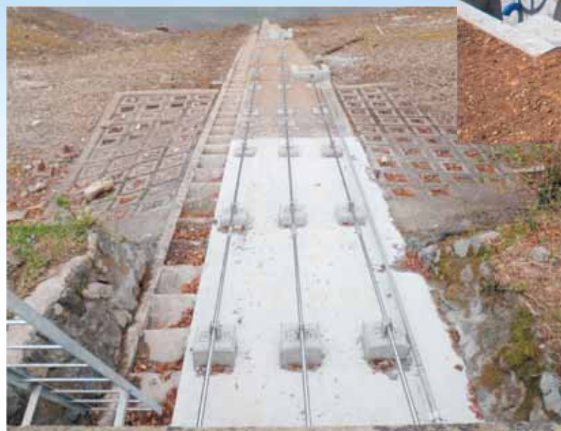
●伊賀市柘植町(伊賀農林商工環境事務所) 電動斜樋ゲート φ250mm×10.95m
