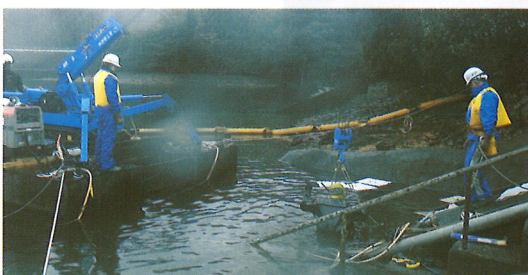
●志摩市磯部町恵利原(三重県企業庁) 神路ダム斜樋ゲート設備改良(潜水作業) 1.5m×2.85m
