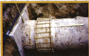
▼PC管丸ゴム飛び出しの漏水
