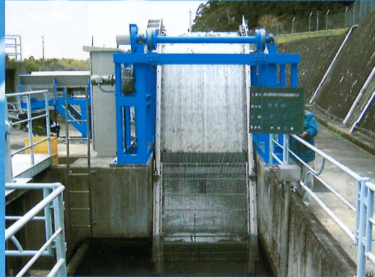
●多気郡多気町(三重県企業庁) 固定式エンドレス自動除塵機 2.0m×2.4m
