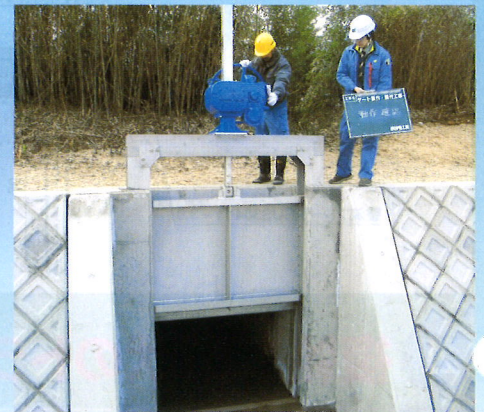
●四日市市中村町 (四日市市農林商工環境事務所) ステンレス製スライドゲート 1.5m×1.0m
