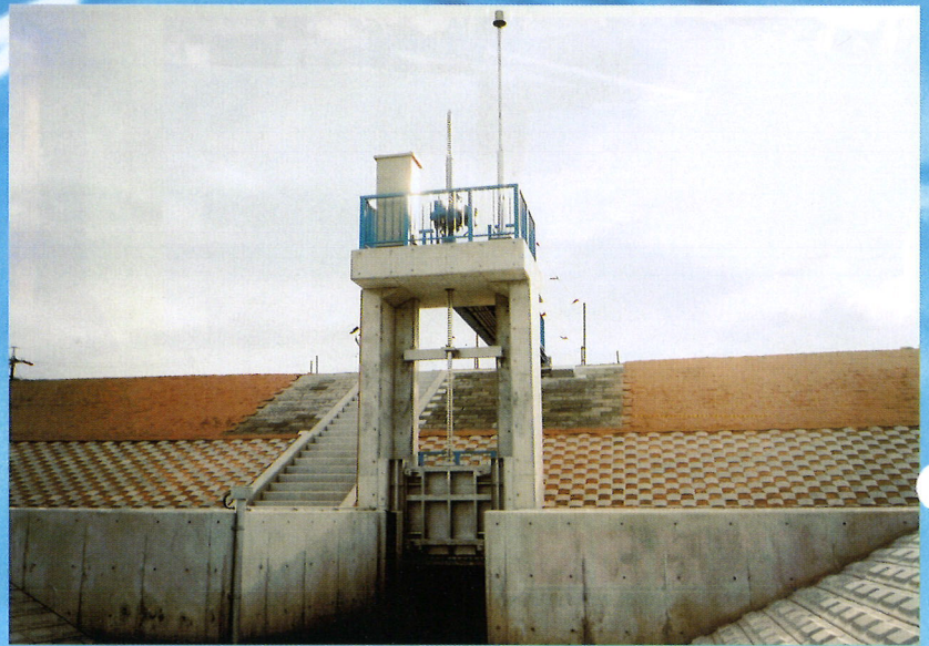
●揖斐川城之堀排水機樋管(国土交通省) ステンレス製ローラーゲート 1.6m×1.6m
